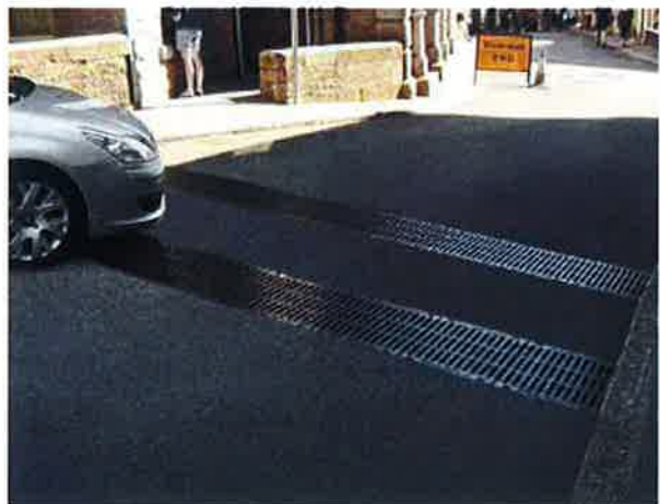
Straßenentwässerung in St. Ives, Cornwall, England
